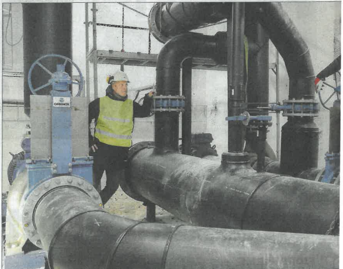
TESTING: Her kjem fjordvarmen inn i energisentralen. Ole Henrik Nilsen i BT Rør (t.h.) gjer klar for testing, mens dagleg leiar i Førdefjorden Energi, Leif Olstad, tek eit overblikk. FOTO: SIGURD LØSETH
