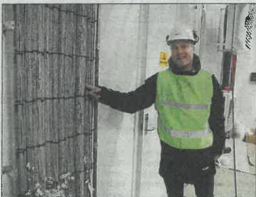
MYKJE UTSTYR: Ein del kablar å halde styr på. Alt blir overvaka elektronisk. Oppstår det feil, vil alarmen gå med ein gong. Anlegget er bygt for å unngå ei kvar form for stans i leveringa.
